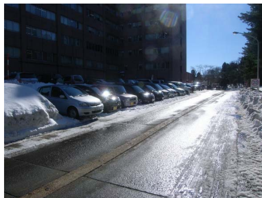
周回道路に敷設された消雪パイプ
