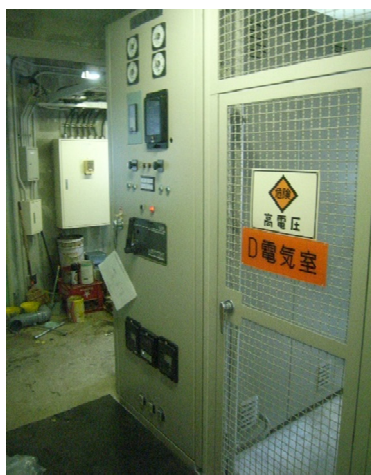
1981年設置の受変電設備 (経年35年)
