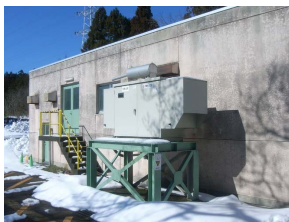
汚水処理場（手前は非常用発電機）
