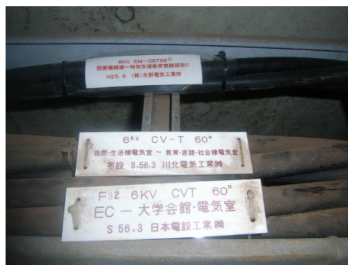
1981年敷設の高圧ケーブル (経年35年)
