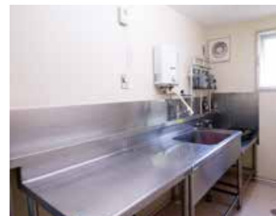
補食室（共用、各階1ヶ所） コイン式ガスコンロ・瞬間湯沸器
