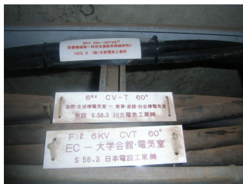
1981年敷設の高圧ケーブル (経年35年)
