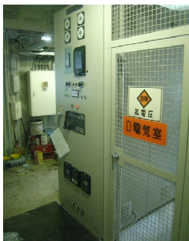
1981年設置の受変電設備 (経年35年)
