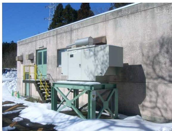
汚水処理場（手前は非常用発電機）
