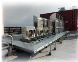
高効率空調設備室外機
