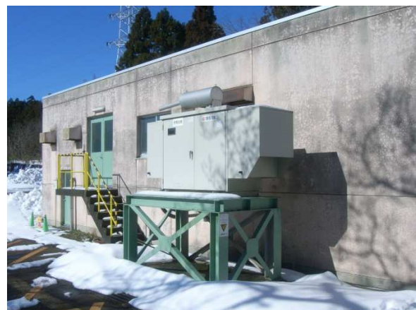
汚水処理場（手前は非常用発電機）
