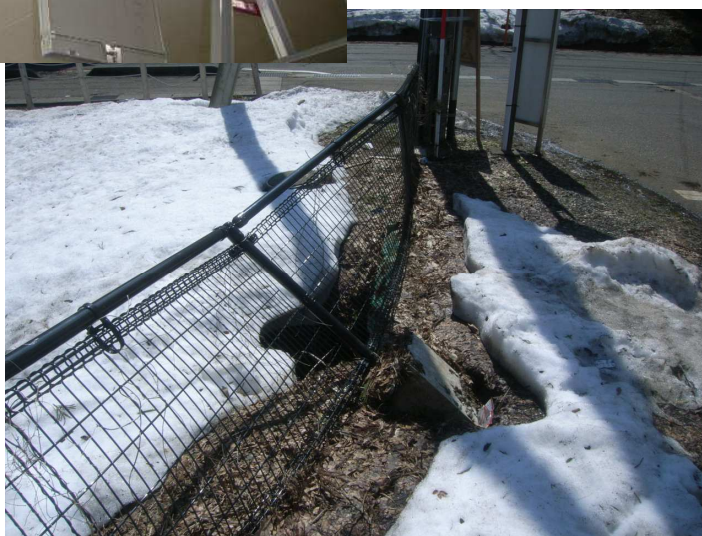
積雪荷重によるフェンス破損
