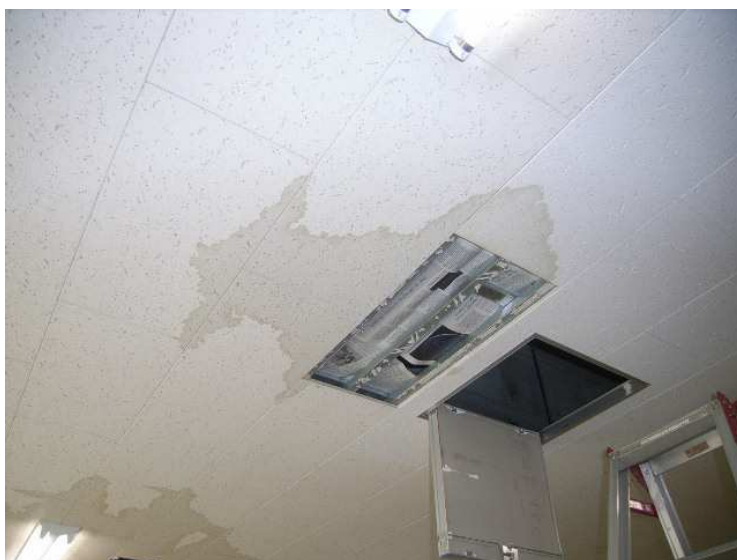
自然棟排水詰まりによる漏水
