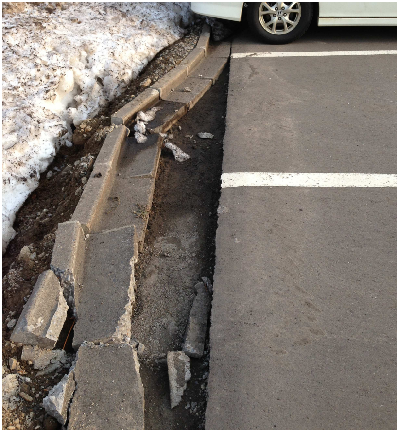
No.16 駐車場において融雪時に破損した L 型側溝
