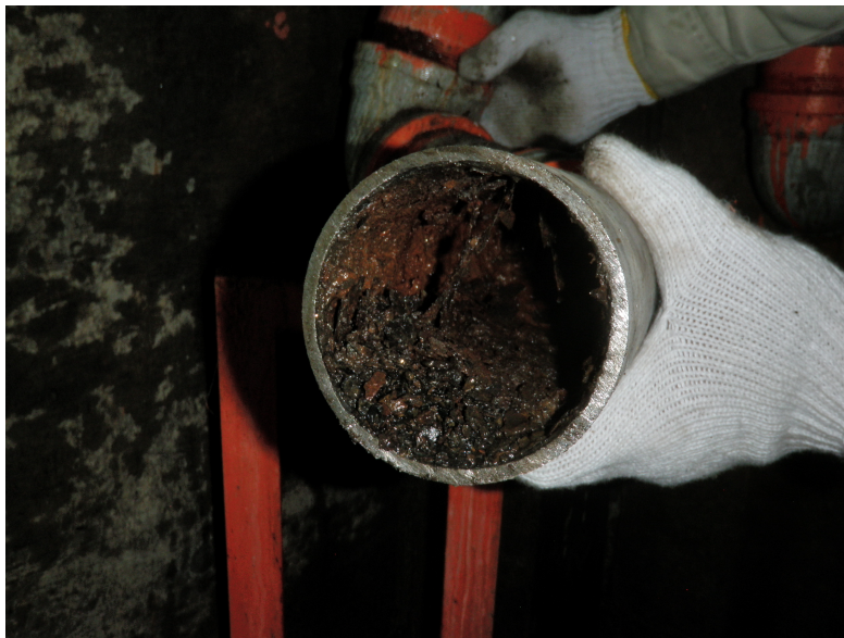
自然棟配水管詰まり による漏水
