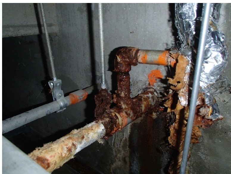
大学会館給水管腐食 による漏水
